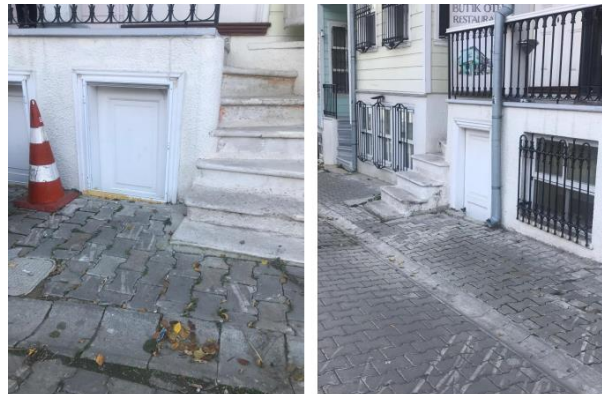
Şekil 14. Konutların restorasyon sonrası bodrum kat sokak giriş kapıları ve giriş nişine ulaşan merdiven basamakları
