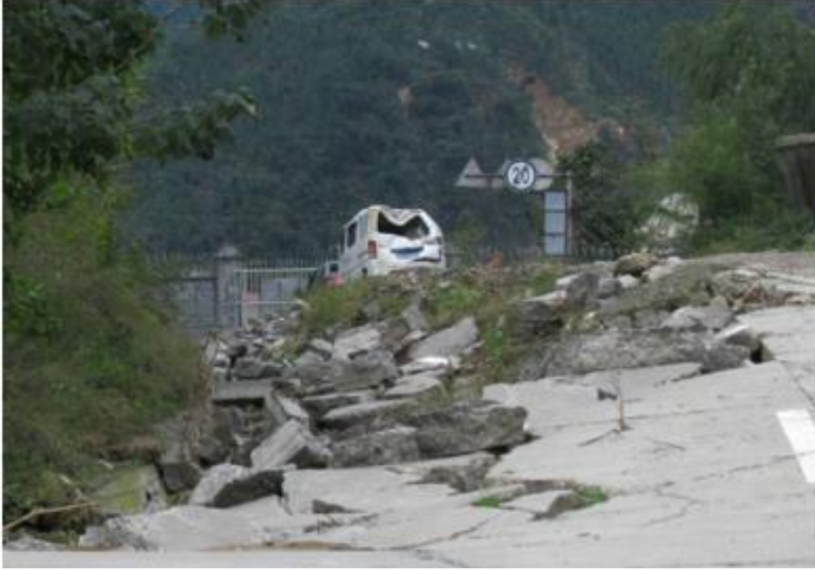
Şekil 7. Beichuan Depreminden Görünüm (Huang vd. 2012: s.1003).
